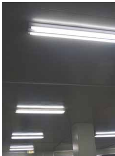
埼玉工場のLED照明
