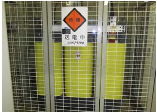
更新したトランス(変圧器)(富士裾野工場)
