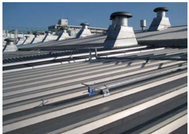
屋根の散水装置(埼玉工場)
