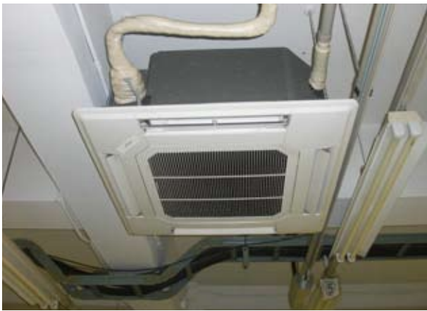
更新した空調設備(平塚工場)
