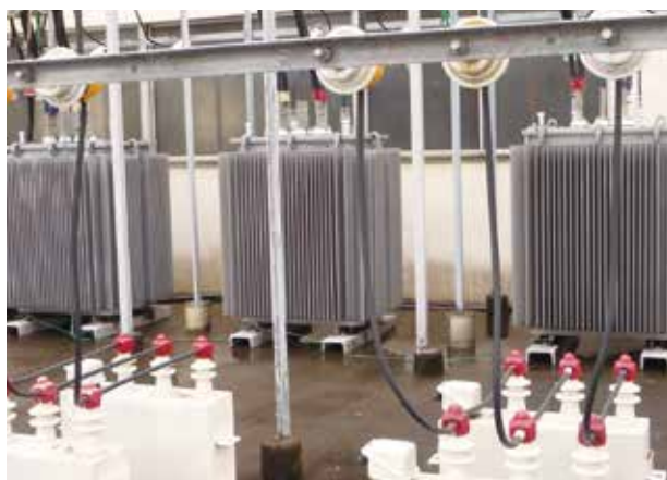
統廃合した高圧機(平塚工場)
