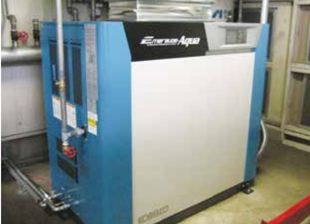
更新したコンプレッサー(野木工場)
