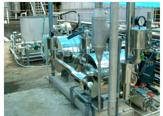
污水処理施設に設置の汚泥減容化装置
